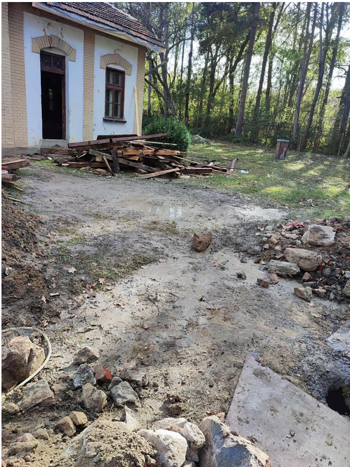
Снимка 7. Следи от бъркания на ръка бетон директно върху тревата в двора.
