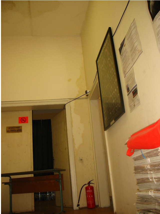
Снимка 7. Мокра и мухлясала стена до входа на аудитория „Акад. Никола Бонев“.
